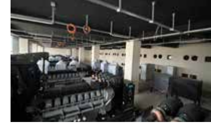
Mardin 750 Yataklı Şehir Hastanesi Ülke: Türkiye Sektör: İnşaat Jeneratör: 6 x AP 2500 Toplam Güç: 12 MW
