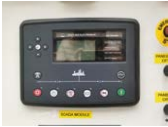
1- Enerji Yönetim Sistemi (EMS) kontrol sistemi
